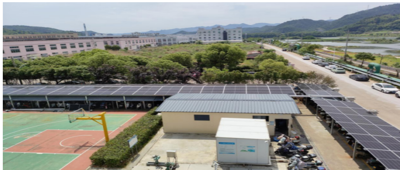
光伏发电项目
